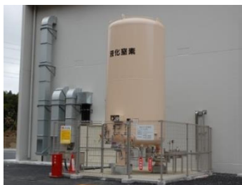
屋外液体窒素CEタンク 1ヶ月分以上の備蓄
